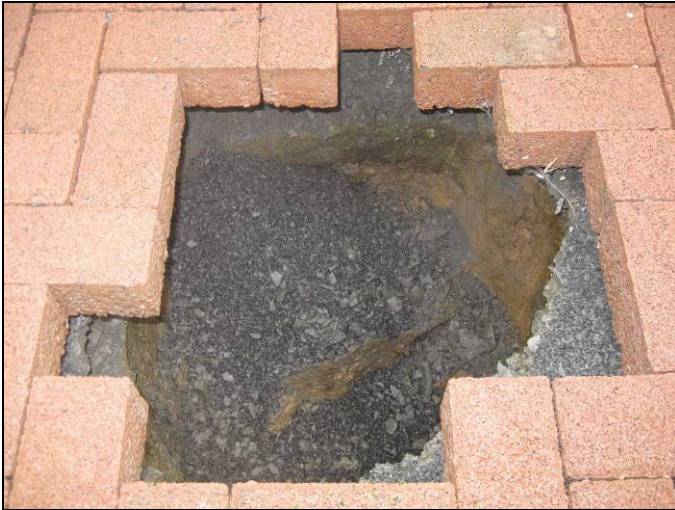
Abbildung 5-13: Setzung infolge Frostbildung in der Erdwärmesondenbohrung (Quelle: HLUG).
