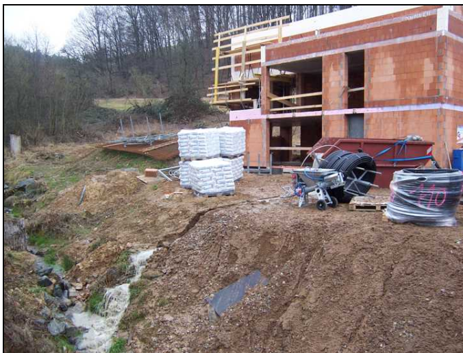
Abbildung 5-14: Verschmutzung eines Oberflächengewässers infolge einer überlaufenden Spülwanne (Foto: Rumohr).
