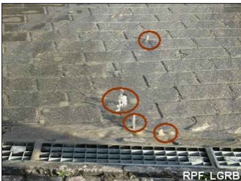
Abbildung 5-5: Artesischer Grundwasseraustritt einige Meter neben einer EWS-Bohrung (Quelle: LGRB).
