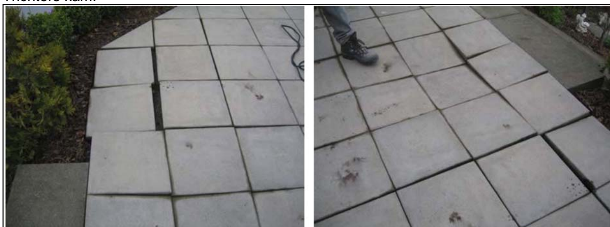
Abbildung 5-10: Senkungen und Hebungen verursacht durch eingefrorene Zuleitungen einer Erdwärmesondenanlage (BASSETTI et al. 2006).
