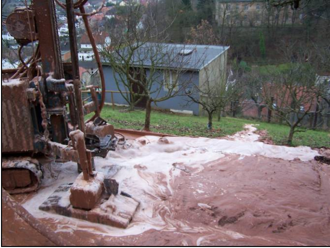
Abbildung 5-16: Verschmutzung eines Grundstücks durch unkontrolliertes Ableiten von Bohrspülwasser inkl. bohrlochstabilisierender schäumungsaktiver Substanzen (Quelle: TLUG).
